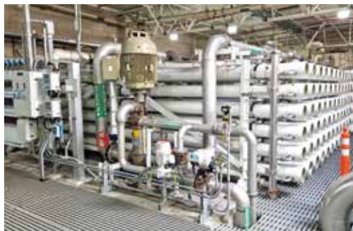
Figur 6: Omvänd osmosfilter i Robert W. Goldsworthy Desalter.
