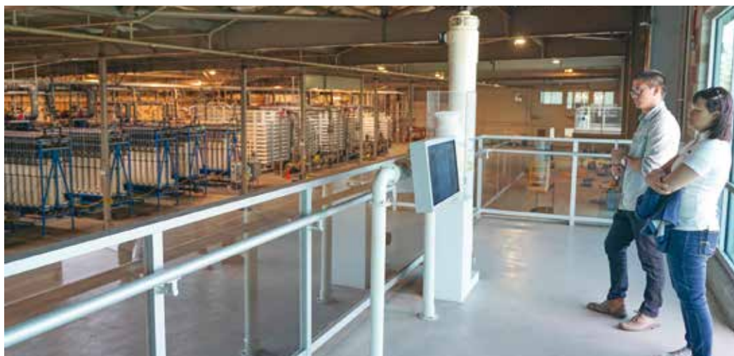
Figur 4: En av de tre utsiktsbalkongerna i Albert Robles Center. I bakgrunden syns ultrafilter (stående tuber) och omvänd osmosfilter.
